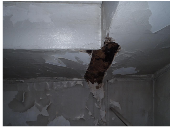
Kuva 10. Ullakkokerroksessa on muutamia kosteusvauriokohtia.
