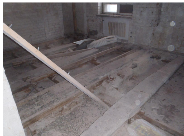
Kuva 8. Osassa toisen kerroksen tiloista välipohjan palkit ovat näkyvissä. Palkkeissa oleva eriste on kiinnitetty PAH-yhdistepitoisella bitumisivelyllä.
