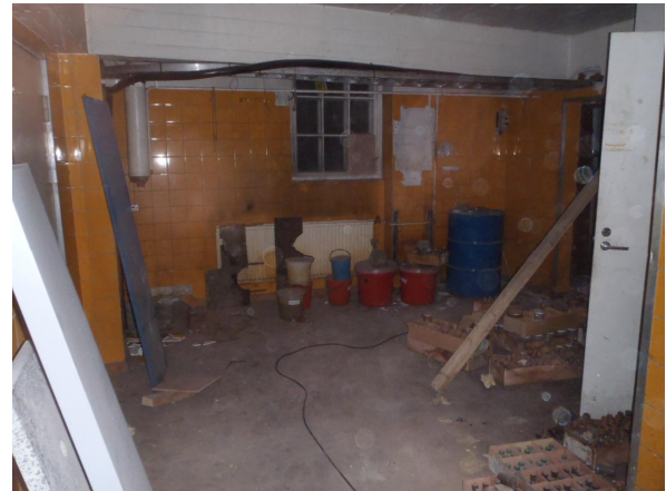
Kuva 5. Oranssin keraamisen laatan saumalaasti sisältää asbestia .
