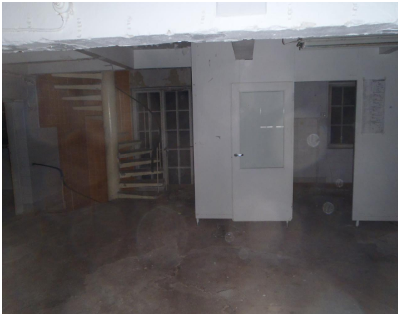
Kuva 4. Kevytrakenteisten toimistokoppien seinälevyt sisältävät asbestia .
