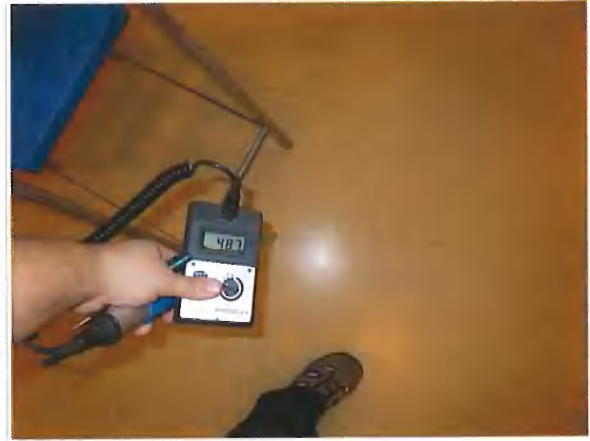
Vauriokohdan alapuolella lattiassa ei havaittu kohonneita vertailuarvoja
