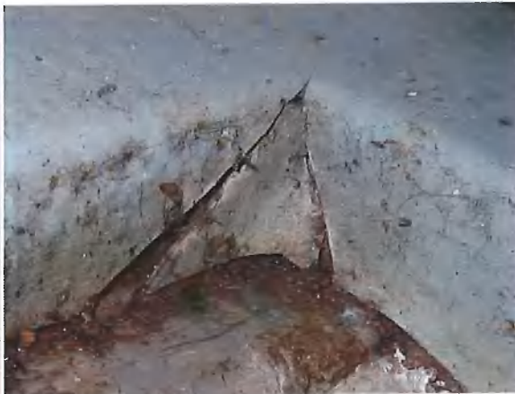
Muovimaton liittymisessä lattiakaivoon havaittiin puutteita
