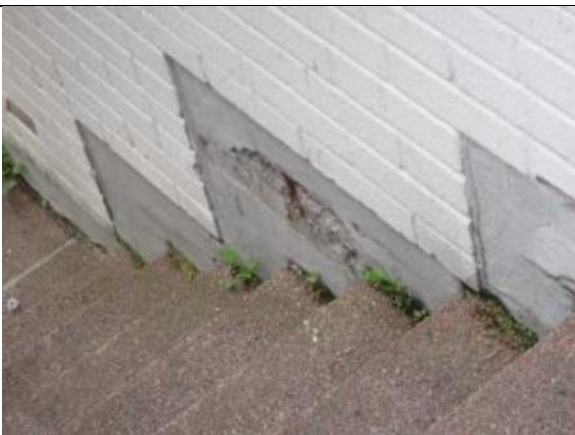
Kuva 17. Toimistolaajennus B:n portaikon viereisiä ulkoseinän vaurioita.
