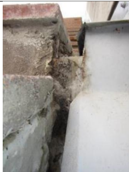
Kuva 6. Portaan ja elementin väliset tiivisteet ovat vaurioituneet.
