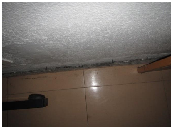
Kuva 23. Vanhan jäähallin alapohajn ja väliseinän välissä rako. Tilassa mikrobiperäinen haju.
