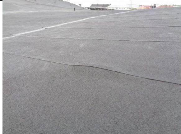
Kuva 51. Vesikatteessa ilmankosteuden aiheuttamia pusseja.
