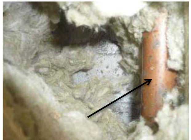
Kuva 66. Ulkoseinässä havaittiin kupariputki
