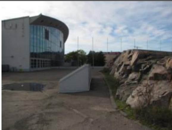
Kuva 9. Vesi lammikoituu käännettyyn kattorakenteen päällä.
