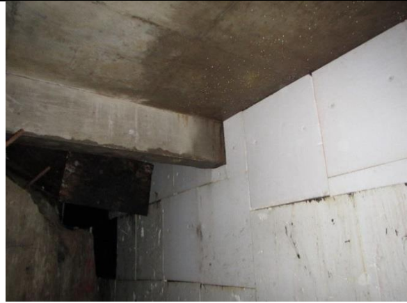
Kuva 27. Harjoitushallin maanvastaiseen seinään rajautuvassa betonirakenteessa runsaasti kosteutta yläpuolisessa betonirakenteessa.
