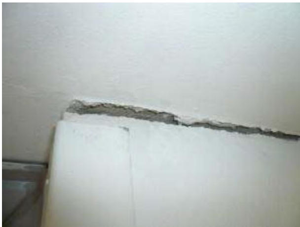
Kuva 52. Muuratun seinän ja betonipalkin liittymä on auennut
