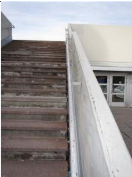
Kuva 5. Portaiden sadevedet johdettu portaan ja kaide-elementin välissä. Rakenne ei ole tiivis. Harjoitushallin toimisto-osa.
