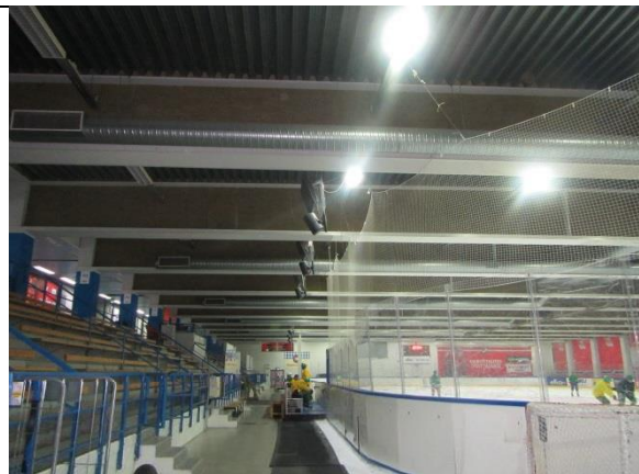
Kuva 59. Harjoitushallin yläpohjan teräspalkkien palonsuojaeristeessä havaittiin kosteusvaurioon viittaavaa mikrobikasvustoa.
