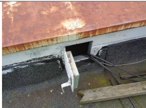
Kuva 53. Yläpohjaan johtava tarkastusluukku ei ole tiivis.
