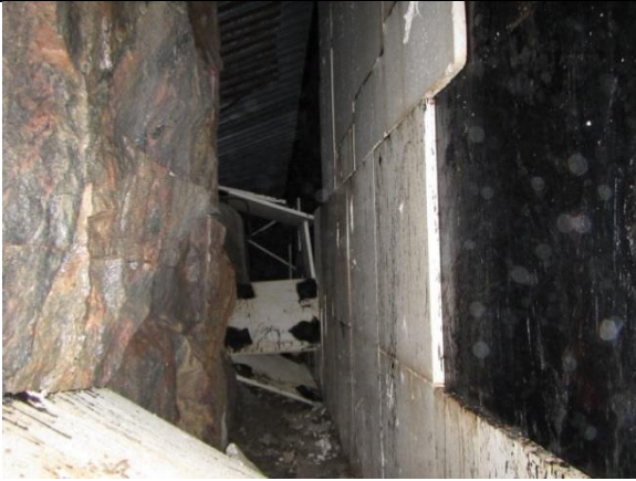
Kuva 26. Harjoitushallin maanvastaisten seinien lämmöneristeet ovat irronneet.
