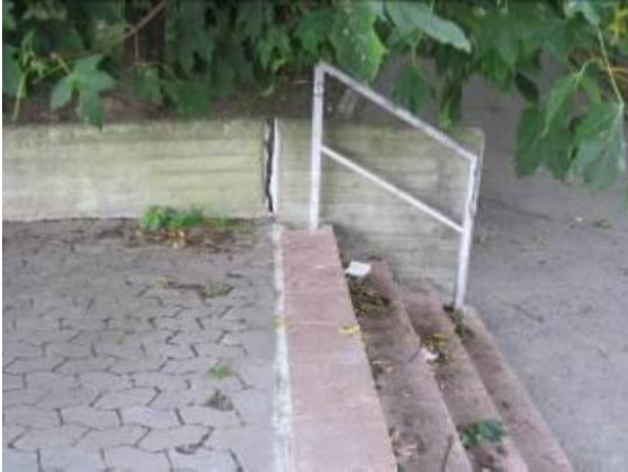
Kuva 1. Portaikko parkkialueelle, vaurio kaide-elementissä.
