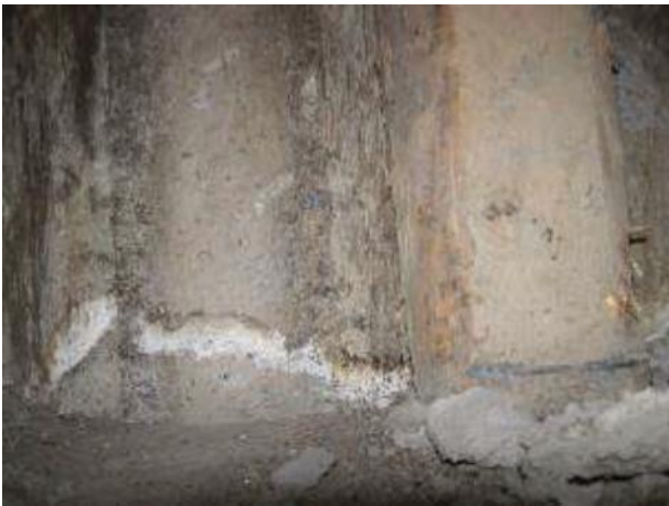
Kuva 30. Seinän alaosassa betonirakenteessa kalkkihärmää kosteuden vaikutuksesta
