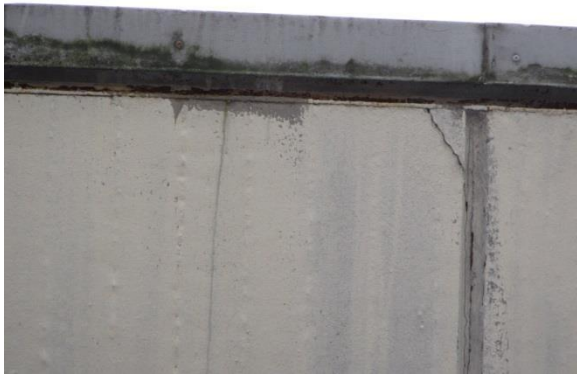
Kuva 56. Rästään vaurioita vanhassa jäähallissa.
