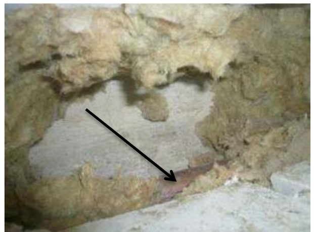
Kuva 64. Ulkoseinässä havaittiin kupariputki
