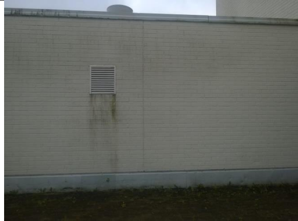
Kuva 39. Toimistolaajennus B:n tiiliseinän eristeessä havaittu mikrobivaurio.
