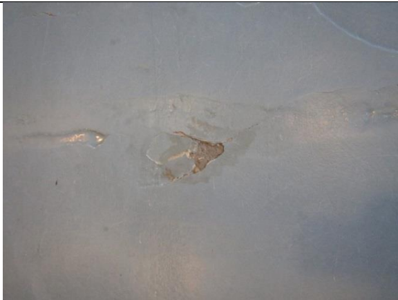
Kuva 20. Vanhan jäähallin yleisöaulan alapohjan pinnoitevaurio
