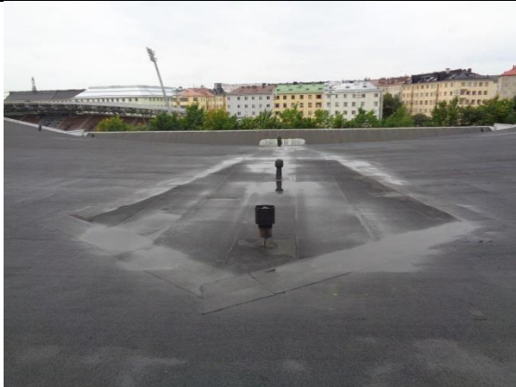
Kuva 50. Vanhan jäähallin vesikate. Vesi lammikoituu keski-alueelle.
