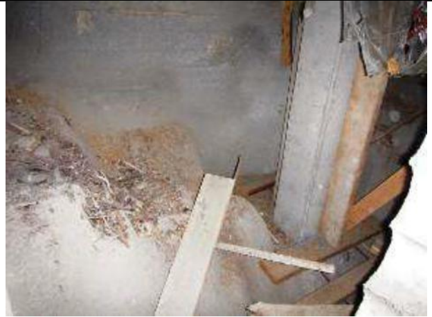
Kuva 34. Ontelotilassa on runsaasti rakennusjätettä
