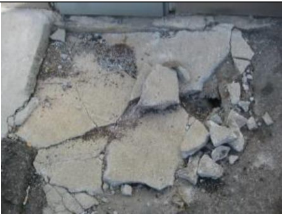
Kuva 15. Asfaltointi halkeilee maassa olevan vajoaman vuoksi vanhan jäähallin sokkelin vieressä.
