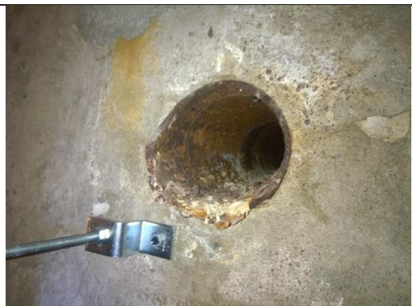
Kuva 31. Vanhan jäähallin putkitunnelissa tulppaamaton vanha viemäri.
