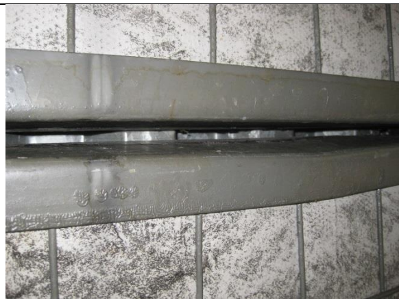
Kuva 57. Vanhan jäähallin yläpohjan teräskasettien väleissä ei ole enää saumausta.
