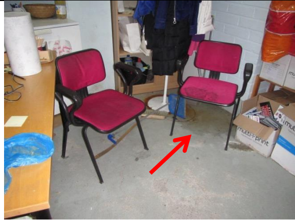
Kuva 49. Harjoitushallin välipohjassa vettä liikuntasaunan vuodon vuoksi.
