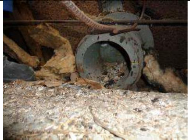
Kuva 85. Yläpohjaa kannattelevan kaapelin ankkurissa lievää korroosiota
