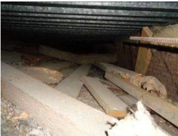
Kuva 86. Yläpohjatilassa rakennusjätettä, oikealla kehät yhteen sitova korkkieristeinen teräsbetonipalkki
