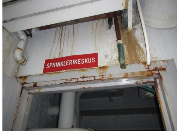
Kuva 43. Harjoitushallin ja vanhan jäähallin rajalla sijaitsevassa sprinklerikeskuksessa yläpuolinen vesivuoto liikuntasaumasta.
