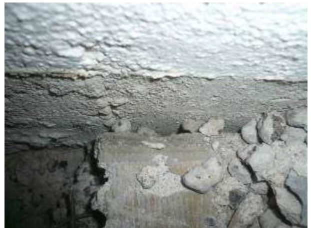
Kuva 14. Seinän ja lattian liittymä ei ole tiivis
