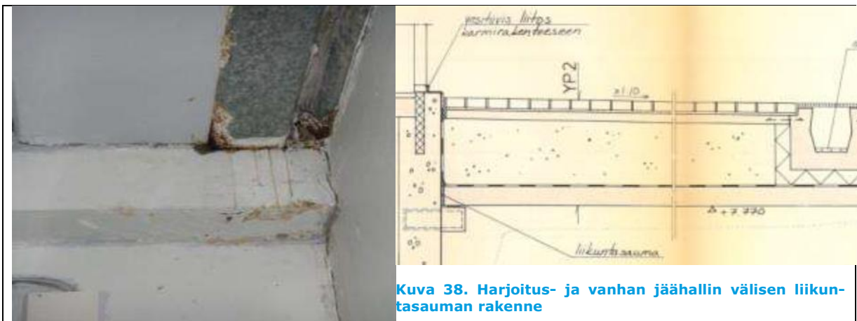
Kuva 37. Harjoitushallin ja vanhan jäähallin välisessä liikuntasaumassa vuoto
