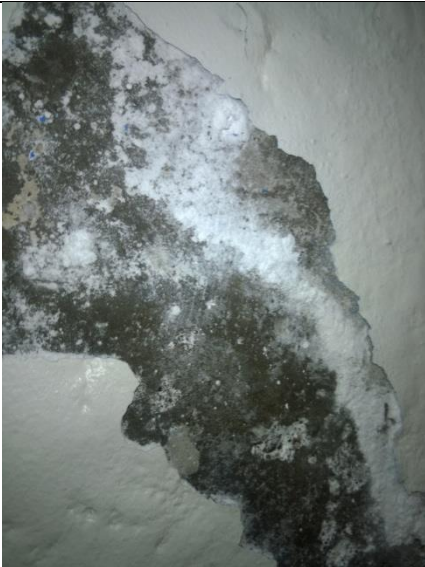
Kuva 28. Harjoitushallin maanvastaisen seinän kosteusvaurioitunutta maalikerrosta.
