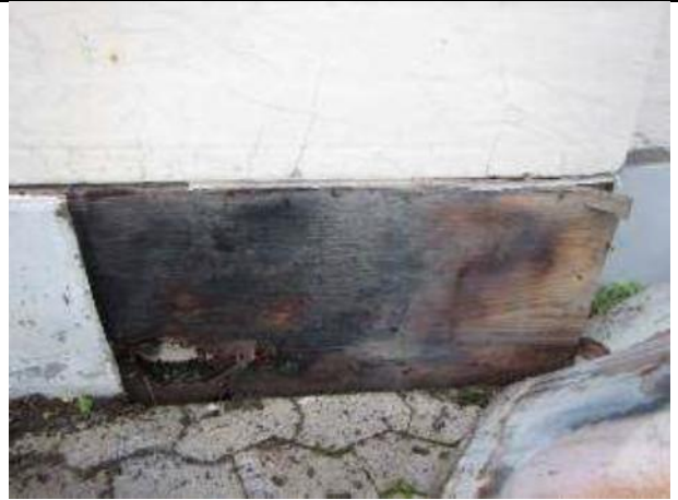
Kuva 59. Sokkelipellin takana palovaurioitunut vanerilevy
