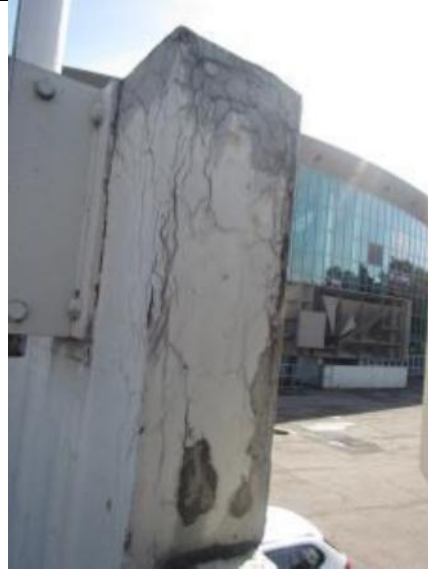
Kuva 14. Pakkasrapaamaa betonissa toimistolaajennus A:n kaiteessa.
