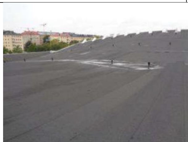
Kuva 35. Vettä lammikoituu katon keskellä
