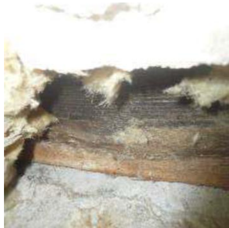
Kuva 46. Eristetilan vaakarimoituksessa on lahovaurioita
