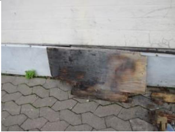
Kuva 19. Harjoitushallin sokkelirakenteesta löydetty palovaurioitunut vaneri.
