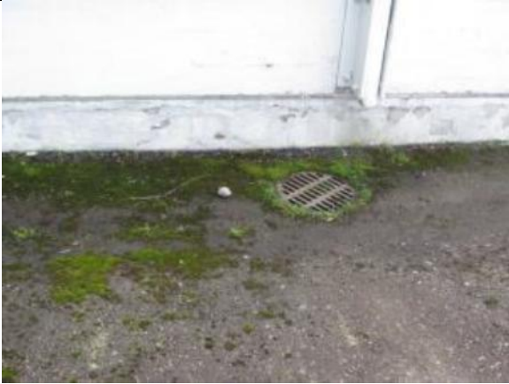
Kuva 13. Lätäköitymisestä johtuvaa sammaloitumista, vedenpoisto ei toimi.
