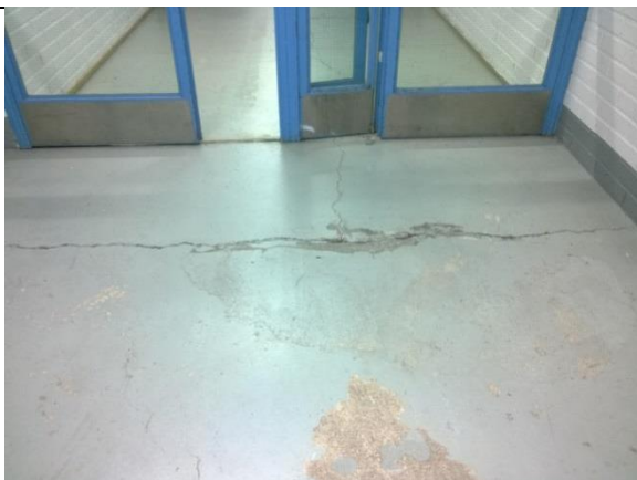
Kuva 22. Liikuntasauman vaurio vanhan jäähallin ja harjoitushallin välissä.
