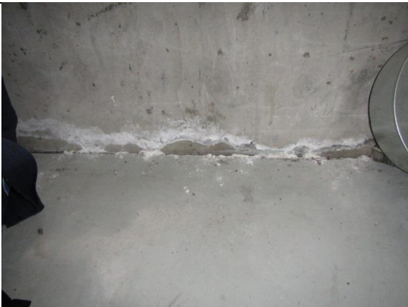
Kuva 44. Kosteusvauriojälkiä väliseinän ja alapohjan liitoksessa harjoitushallin pohjakerroksessa.
