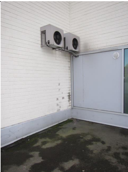
Kuva 34. Vanhan jäähallin tiilijulkisivun vaurio.
