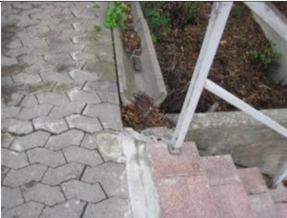
Kuva 3. Sadevedenpoisto harjoitushallin käännetyn katon reunalla on puutteellinen.
