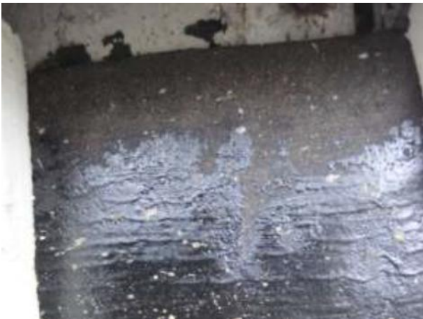
Kuva 58. Käännetyn katon vedeneristeen yläreunan liittymä kantavaan betoniseinään ei ole tiivis
