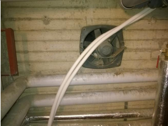
Kuva 32. Vanhan jäähallin huoltotunnelin IV-kanavan päätte- laite ei ole toiminnassa. Ilmavirta huoltotunneliin päin.
