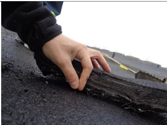
Kuva 52. Vesikatteen kermien yhteispaksuus on jo yli 50 mm.
