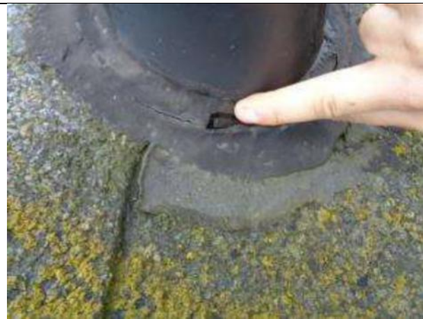
Kuva 33. Läpivienti vaurioitunut alipainetuulettimen juuressa
