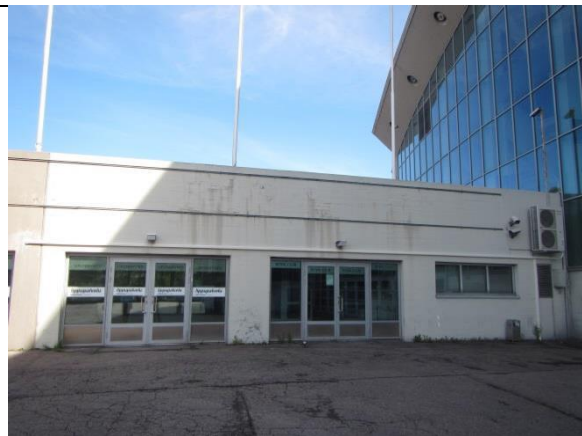
Kuva 37. Käännetyn katon vedenpoiston puutteet aiheuttavat vaurioita alapuolisiin seinärakenteisiin toimistolaajennus A:ssa.
