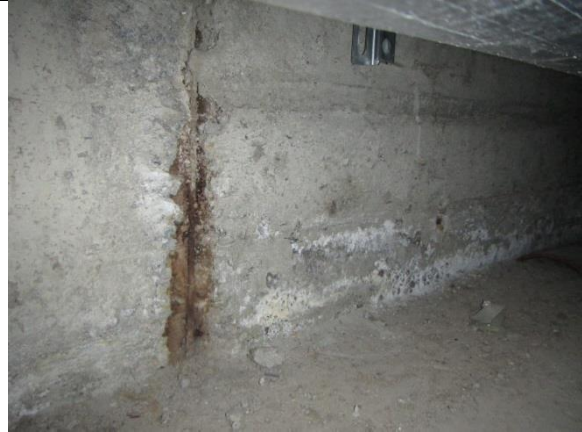
Kuva 33. Kosteuden aiheuttamaa vauriota putkitunnelin lii- kuntasaumassa.
