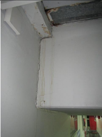
Kuva 62. Harjoitushallin palkin ja väliseinän liittymässä vesivuotojälkiä.
