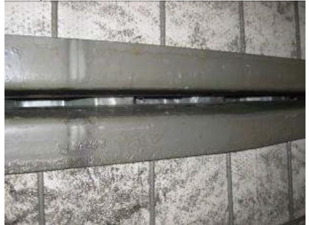
Kuva 89. Teräskasettien väliset tiivisteet ovat pudonneet pois ja raosta havaittiin ilmavirta yläpohjaan päin
