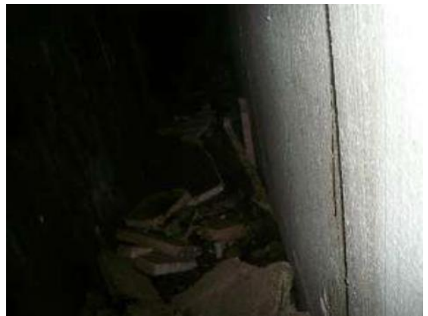
Kuva 39. Seinän eristelevyjä on irronnut laajoilta alueilta
