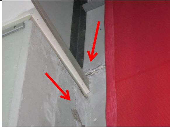
Kuva 61. Harjoitushallin pilasterin ja maanvastaisen seinäliitoksessa halkeamia.
