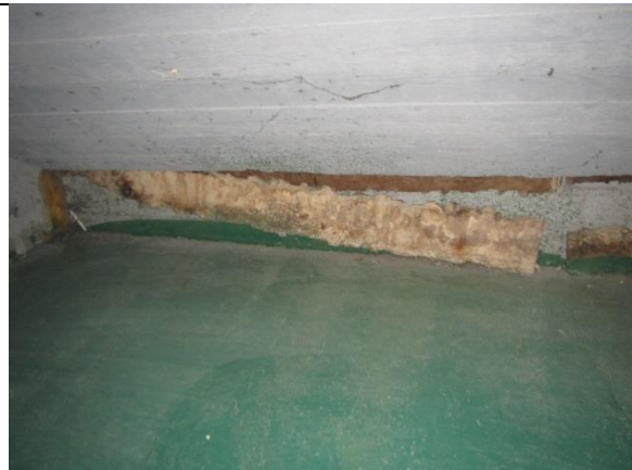
Kuva 45. Portaikon alla liikuntasaumassa vaurioitunutta kova-levyä vanhan jäähallin yleisöaulan varastotilassa.
