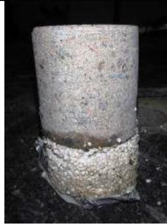
Kuva 2. Alapohjan rakennekerrokset, betonissa ja EPS:ssä havaittiin kosteutta
