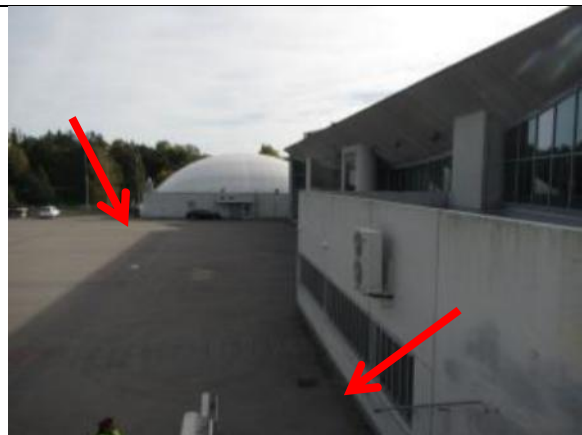
Kuva 18. Piha-alueen valuma-alueet liian laajoja. Vedenpoistopisteet liian kaukana toisistaan
