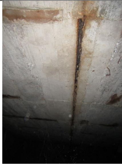
Kuva 25. Liikuntasauama vanhan jäähallin alapohjan ryömintätilassa, materiaali vaurioitunut.
