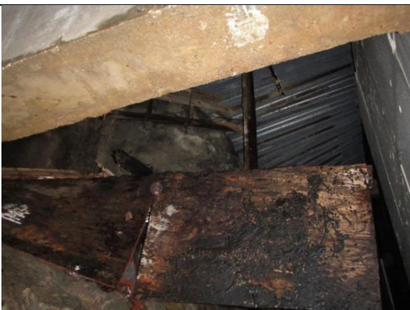
Kuva 30. Harjoitushallin sulkulaattatilassa pahoin vaurioitunutta rakennusjätettä ja muottilautaa.
