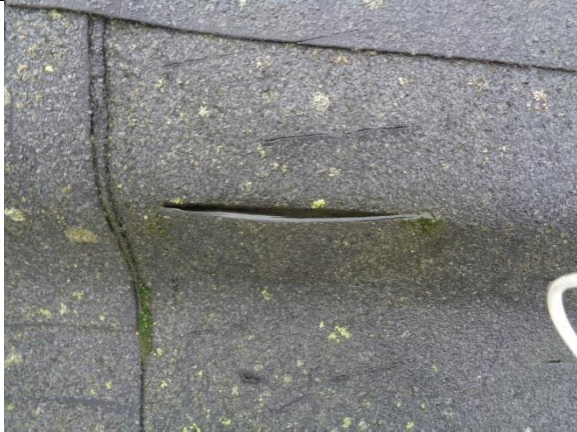
Kuva 54. Vesikatteessa lumen poistosta syntynyt vaurio.
