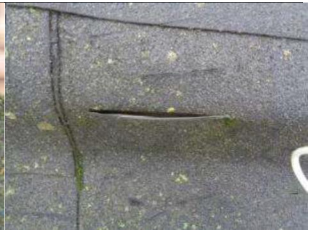
Kuva 34. Lumenpoistotyön aikana syntyneitä vaurioita
