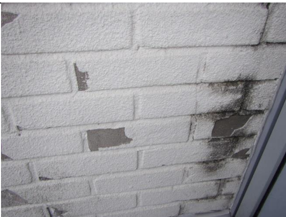
Kuva 36. Rappaus irtoaa tiilipinnasta vanhan jäähallin julkisi- vulla.
