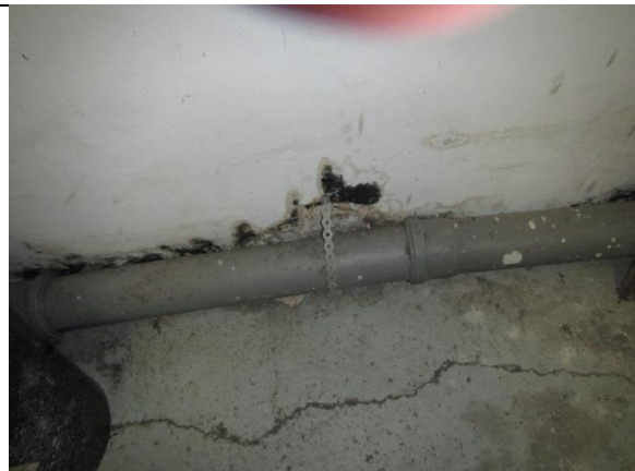
Kuva 47. Vanhassa jäähallissa kosteusvauriojälkiä väliseinän ja alapohjan liitoksessa.
