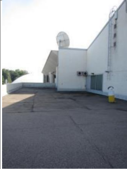
Kuva 8. Harjoitushallin toimisto-osan yläpohjan asfaltissa halkeamia.
