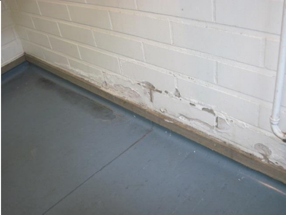
Kuva 42. Kosteusvaurio harjoitushallin WC:n väliseinän alaosassa.
