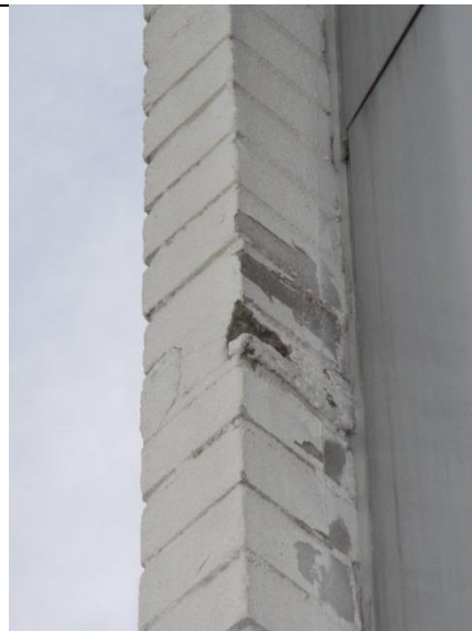
Kuva 35. Vanhan jäähallin tiilijulkisivun vaurio.
