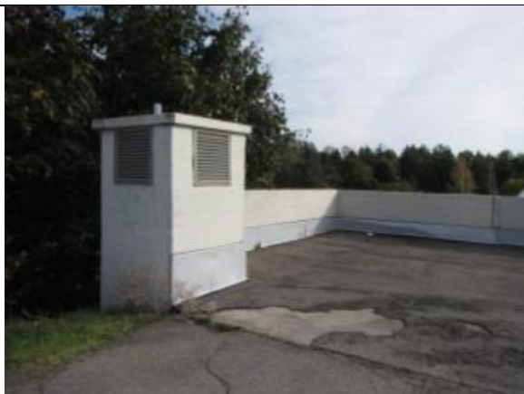
Kuva 11. Asfaltointi irtoaa alustastaan.
