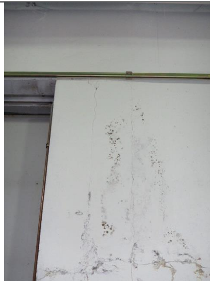
Kuva 41. Harjoitushallin väliseinän kosteusvaurioitunutta maalikerrosta toimistolaajennus B:n puolella.
