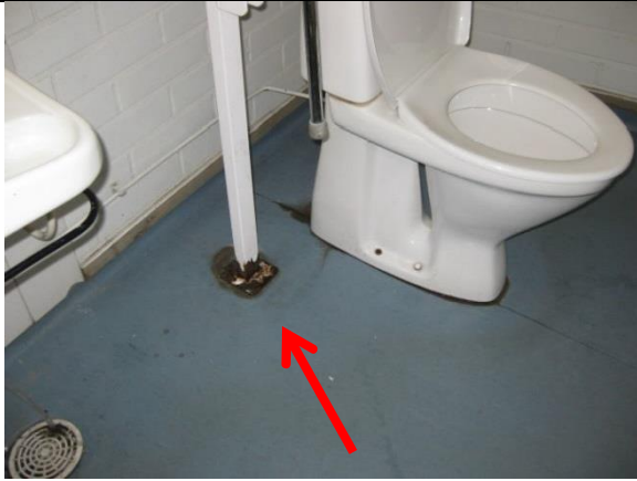
Kuva 48. Harjoitushallin WC-tilan välipohja kastuu liikuntasaunan vuodon vuoksi.
