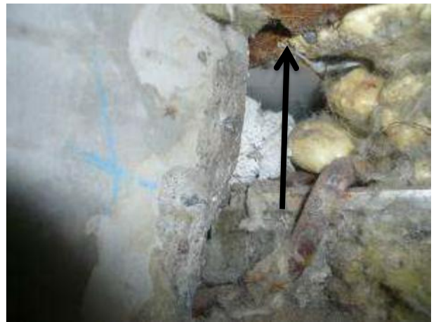
Kuva 54. Ikkunan karmiliittymän kautta on suora ilmayhteys eristetilasta sisäilmaan
