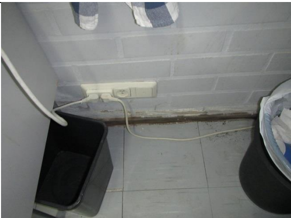
Kuva 46. Harjoitushallin väliseinän alaosassa kosteusvauriojälkiä. Seinän takana vanhan jäähallin ja harjoitushallin välinen liikuntasäuma.
