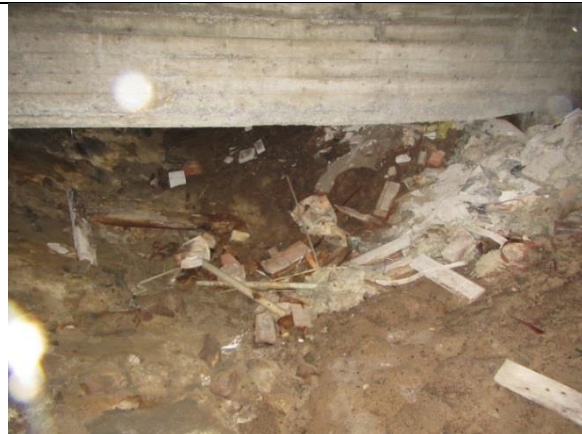
Kuva 21. Vanhan jäähallin alapohjan ryömintätilassa vanhaa muottilautaa ja rakennusjätettä.
