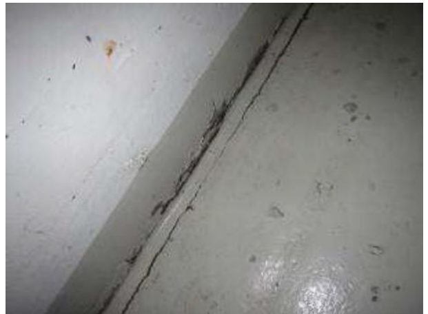
Kuva 6. Tiivistemassa vaurioitunut seinän ja lattian liittymässä
